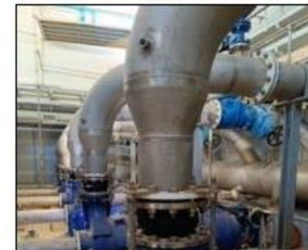
Colector DN-700-350-300-100 de la EBAR (Tuberías)
