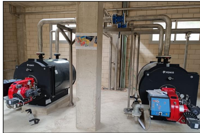
Calderas de agua caliente (T < 110°C) para proceso de calentamiento de fangos en EDAR.
