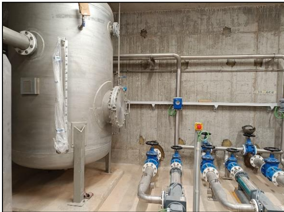
Calderín de presurización del espesador de flotación en EDAR
