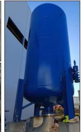
Calderín antiarriete de la EBAR (Recipientes)
